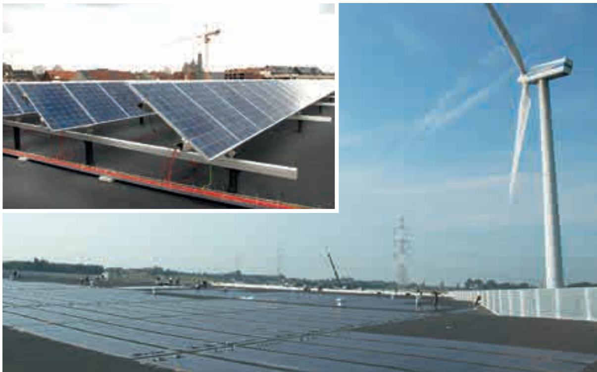
De zonnepanelen op het dak van de Colruyt-winkel te Ninove en het distributiecentrum Dassenveld te Halle
